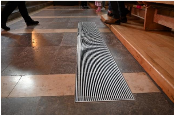
Kirche – Wärme: absenken der Raumtemperatur
