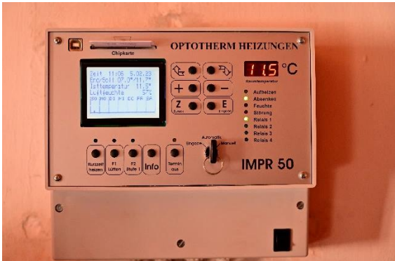
Kirche – Wärme: elektronische Heizungssteuerung
