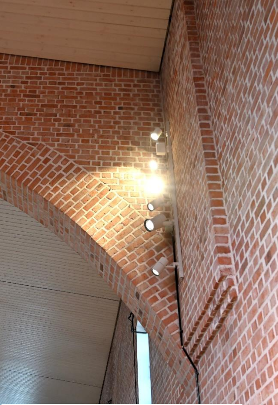
Kirche – Strom: zusätzliche Beleuchtung
